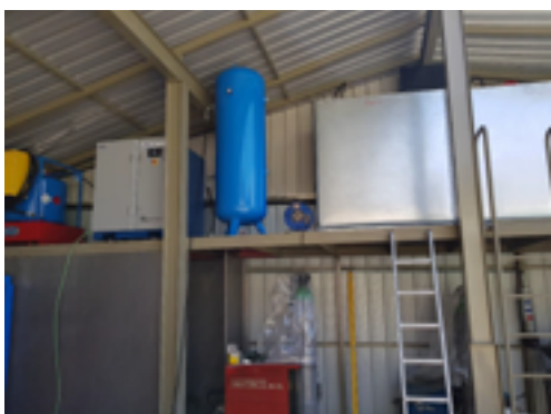
Deposito di fluidi e area di compressione aria
