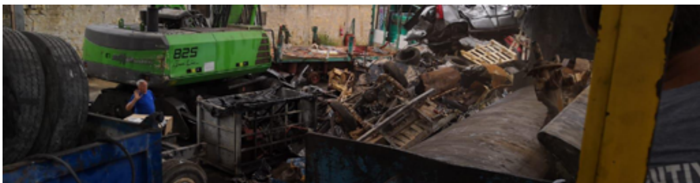
Sito di demonlzione dei F.lli Montalto prima dell'inizio delle attività di LIFE De-Bay
