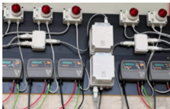
Pannello di controllo dei livelli
